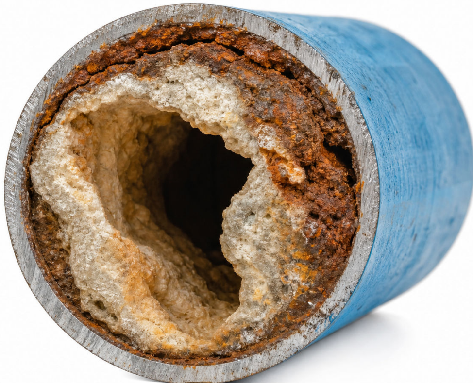
Querschnitt eines korrodierten Heizungsrohrs mit Kalkablagerungen, die den Strömungsquerschnitt verengen
